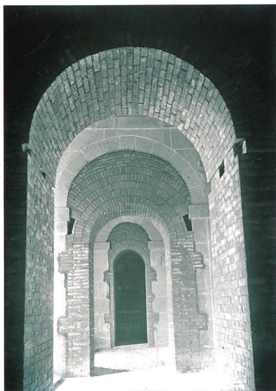
Refuerzo de los arcos de la galería de las tribunas. Foto de Pedro Ibarra cedida por Antonio Serrano Bru
