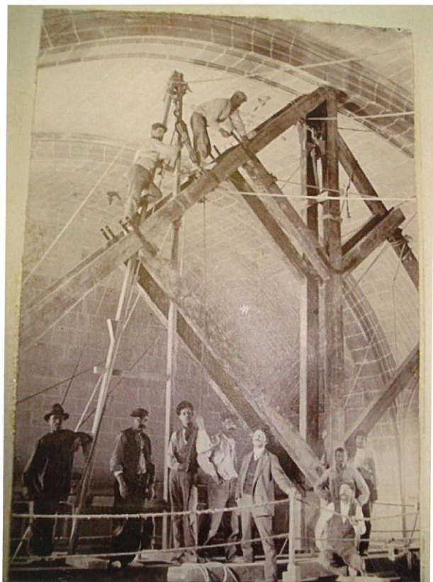
Cimbra que reforzaba el arco de las ánimas mientras se reparaba. Foto de Pedro Ibarra del Libro II cedida por Antonio Serrano Bru
