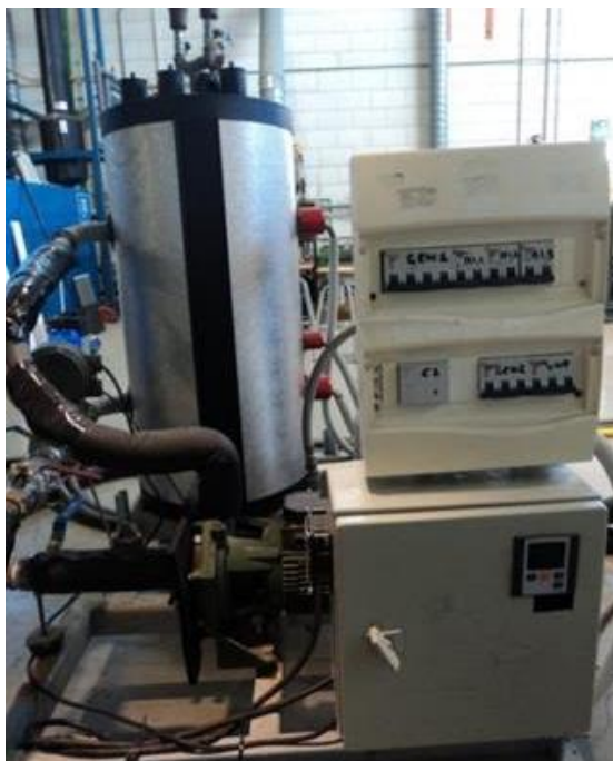
Figura 3.4 Depósito de carga térmica.
