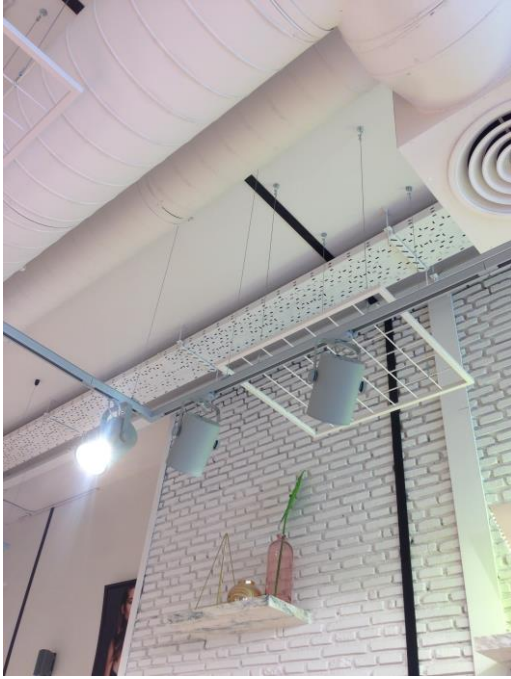
273. Instalaciones de aire y luz a la vista.
