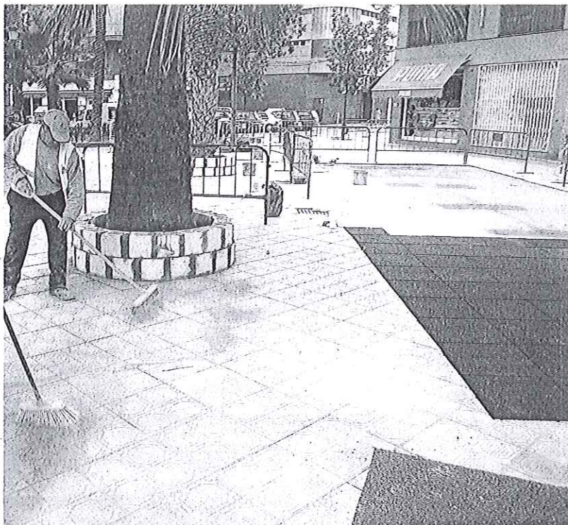
Un operario trabaja en la nueva zona peatonalizada en la plaza de España. :: A.FOTOGRAFÍA
