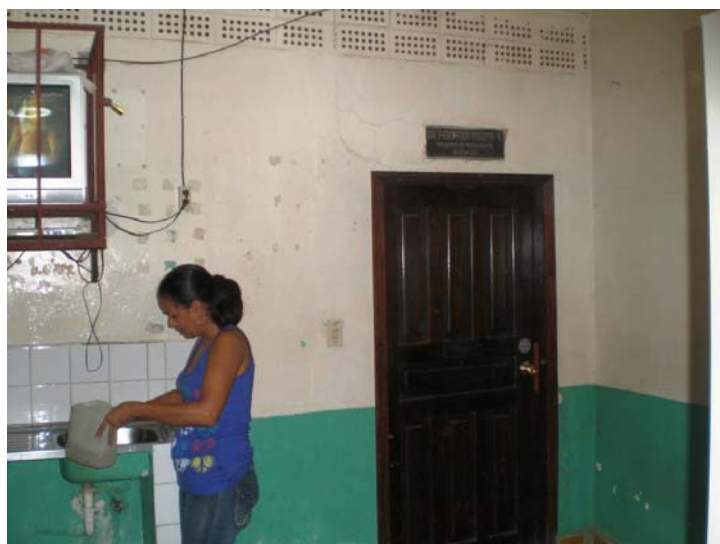
Interior del antiguo centro de salud en proceso de rehabilitación y limpieza.
