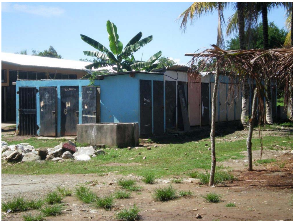
Baños de los alumnos sin acceso a agua corriente.
