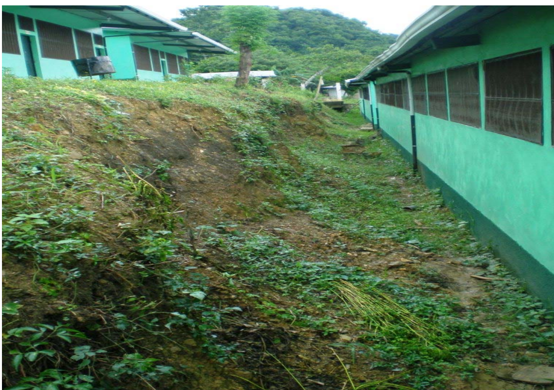
Muro de contención derribado en La Unión. Amenaza las paredes de las aulas. El muro debería estar en disposición semejante al que se encuentra en la zona más alta y que se muestra en la siguiente fotografía. La tercera imagen muestra el detalle de los tubos de salida de agua que deberían haber tenido todos los muros y sólo se hicieron en el más alto.
