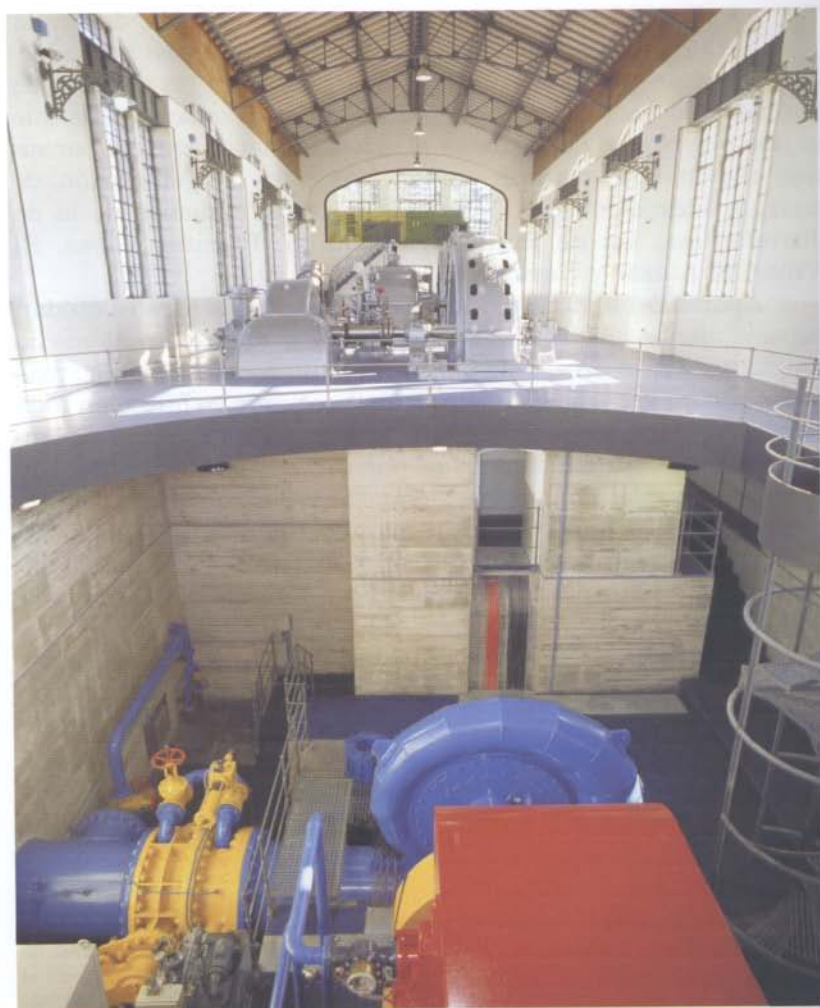
Fig. 2.-Panorámica interior de la Central.
