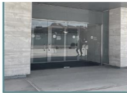
Las entradas al edificio no son claras
