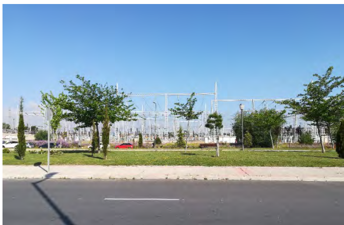
Figura a3.43: Vista de la subestación eléctrica de Coslada desde la acera sudeste de la avenida de la Constitución (fotografía realizada por la autora el 22 de mayo de 2018).
