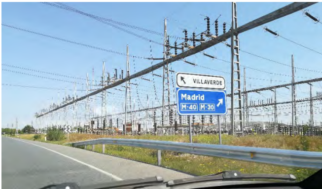
Figura a3.67: Vista de la subestación de Villaverde desde la M-301 (fotografía realizada por la autora el 10 de mayo de 2018).
