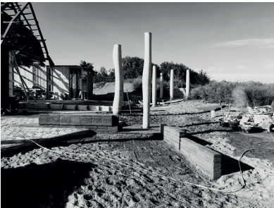
Fig. 244 Plataformas de la entrada, El Pórtico de los Huespédes, Open City Research Platform 2019, Chile.
