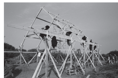
Fig. 54 Construcción colectiva de la estructura de la cubierta, Open City Research Platform 2014, Chile.
