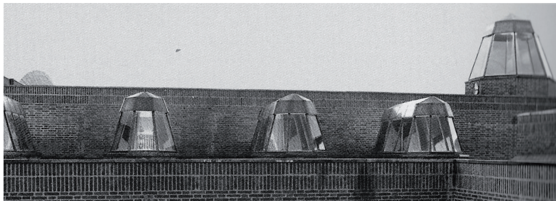
Fig. 23. Lucernarios de la Estación de Comunicaciones por Satélite en Buitrago de Lozoya.
