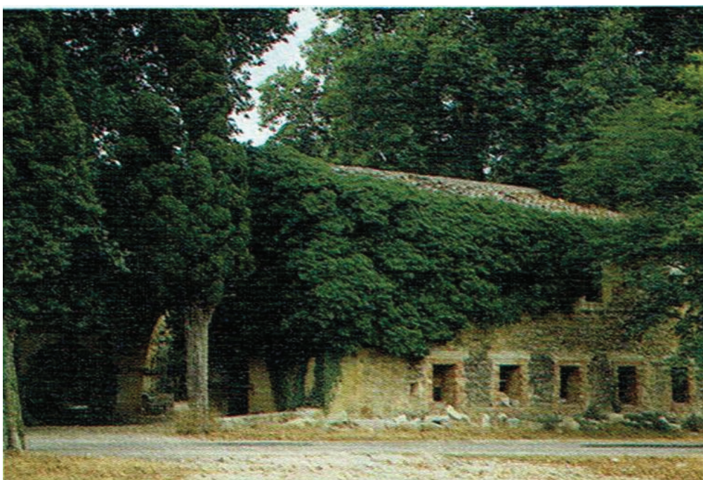
Figura 46: Hiedra, visión general, adosada a la fachada de la ermita de Sant Pau. Albocàcer.
