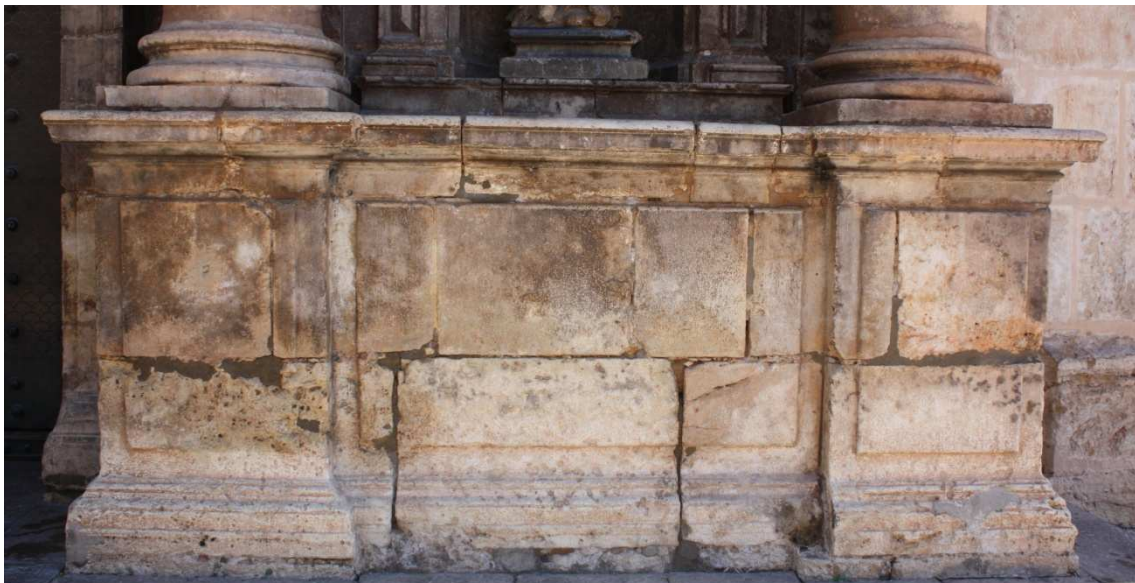
[Fig.V.40.]: Restos de pátina rojiza en la fachada principal.
