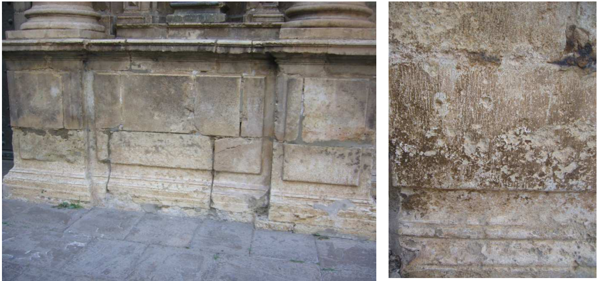
|Fig.V.56.]: Detalle pátina fachada principal.
