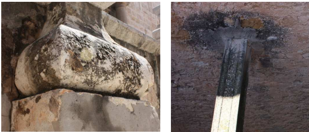
[Fig V.1.]: Detalles de alteración en la iglesia de la Asunción de Lliria.
