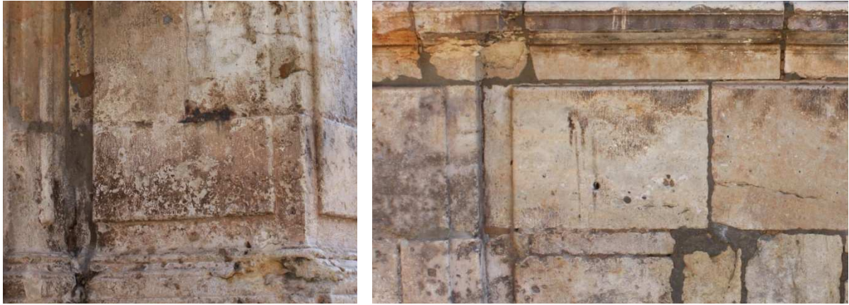
[Fig.V.39.]: Restos de pátina rojiza en la fachada principal.
