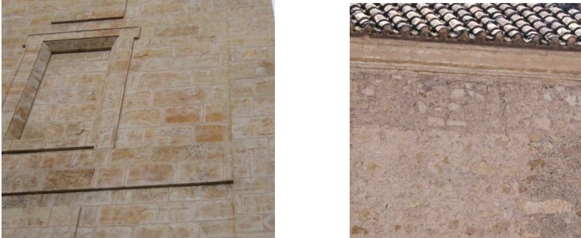
[Fig.V.42.]: Piedra fachada principal (izquierda) y tapial fachadas laterales (derecha).
