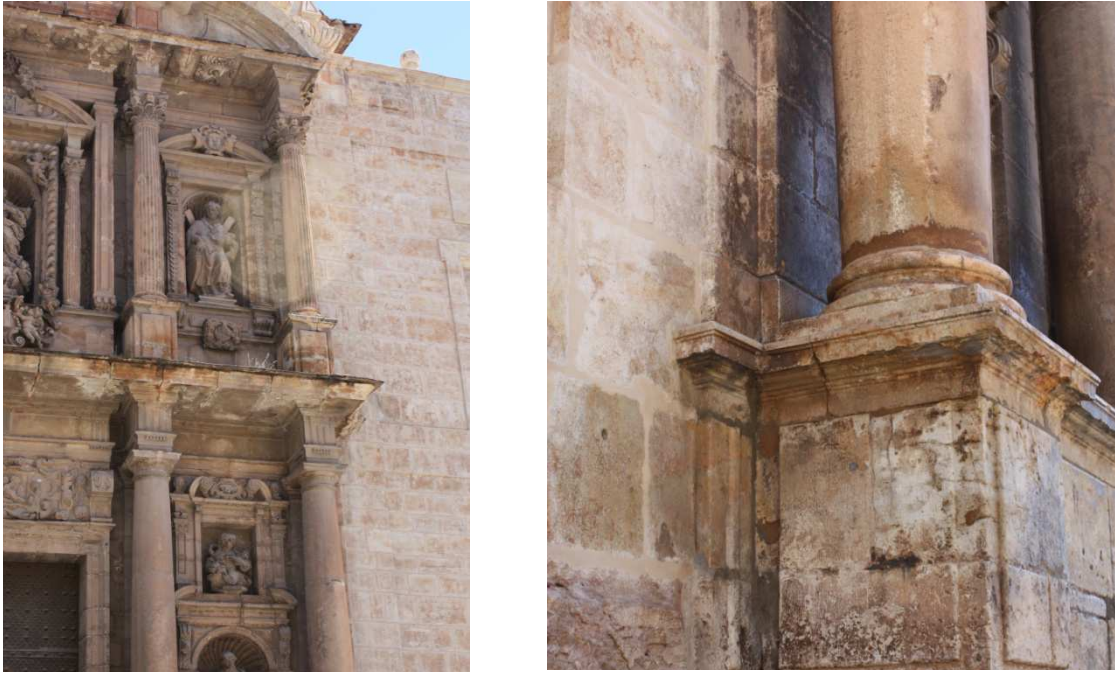
[Fig.V.54.]: Detalle de suciedad fachada principal.
