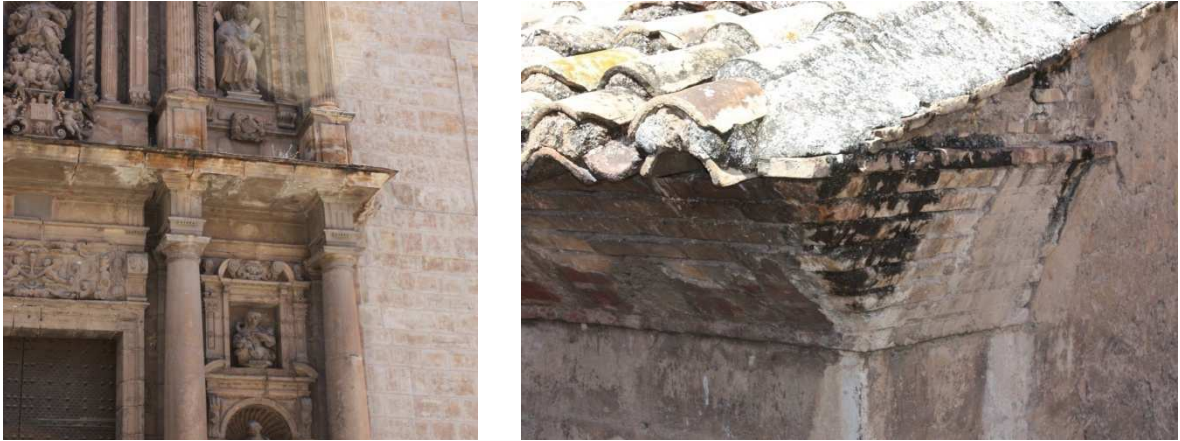
|Fig.V.50. |: Ejemplos de biodeterioro fachada principal (izquierda) y fachada trasera (derecha)
