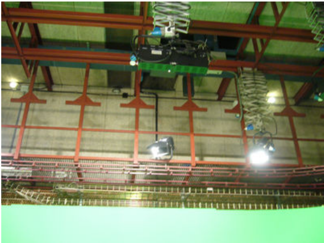
Emparrillado de iluminación en el techo del estudio de EV del canal informativo 24 Horas de TVE en Madrid. Fuente propia. 2006.
