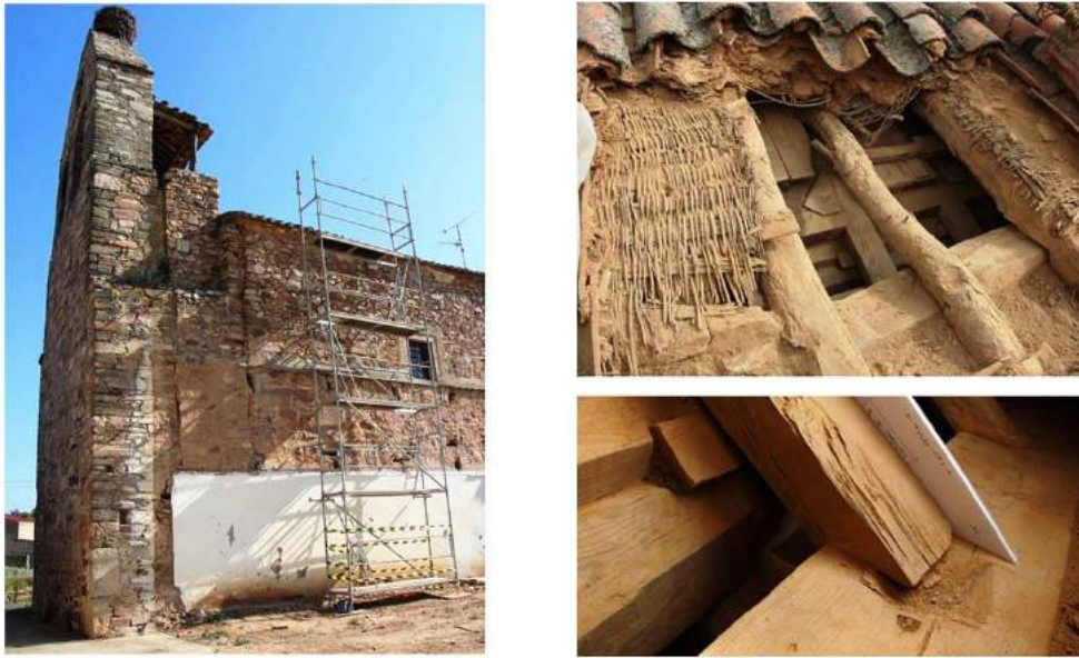
Figura 2. Catas en cubierta para diagnosticar el estado de conservación pero también para conocer el cartabón de la armadura.
